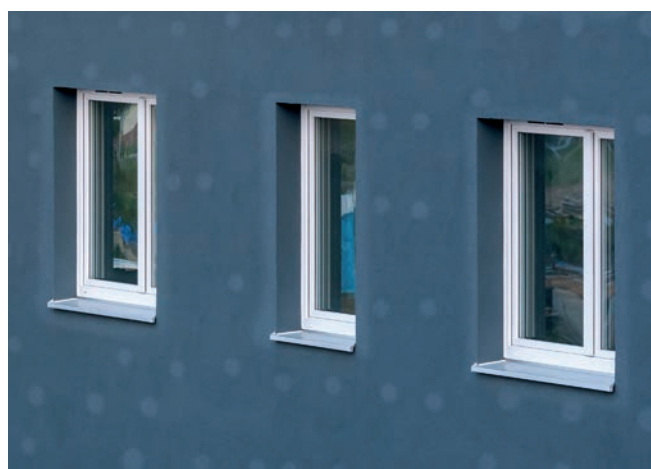
Elewacja, na której nie zastosowano zaślepek do izolacji talerzy łączników mechanicznych.
